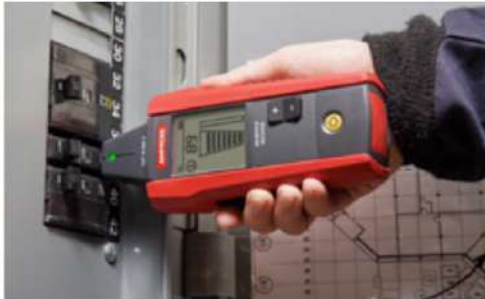
Identifique o único disjuntor correto
